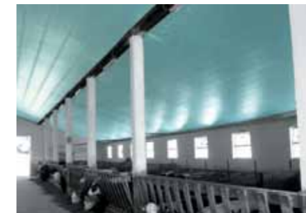
Vidljiva toplinska izolacija FIBRANxps MAESTRO štiti staje i gospodarske zgrade od pregrijavanja ljeti i hlađenje zimi.
